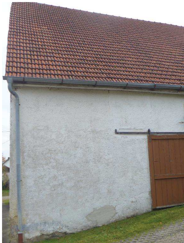
Bachstraße: Bauschäden am Putz einer Scheune
