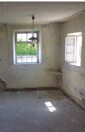
Unterzeller Straße Aufsteigende Feuchtigkeit in Wänden (innen | außen)
